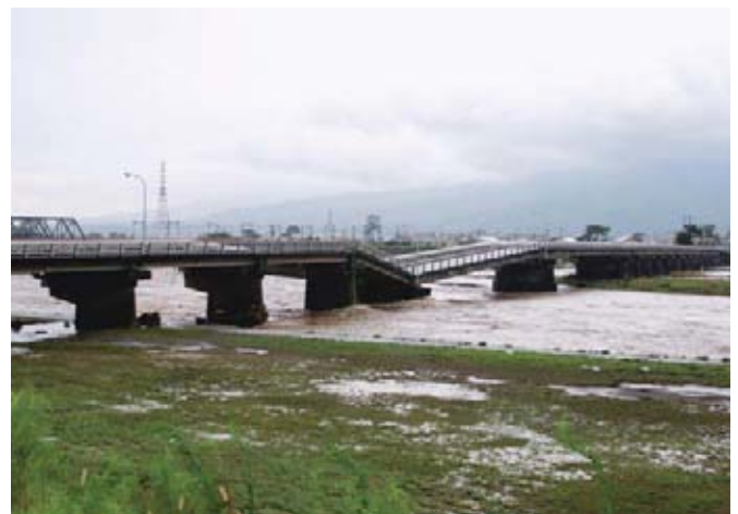
平成19年7月 豪雨による橋の決壊 （写真提供：神奈川県松田町）
